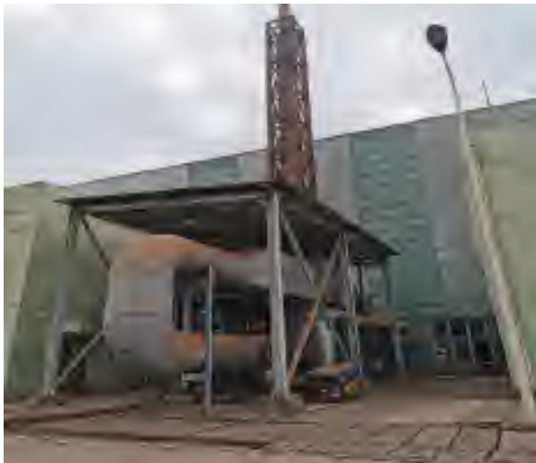
DRAP 脱硝废气处理系统排气筒
