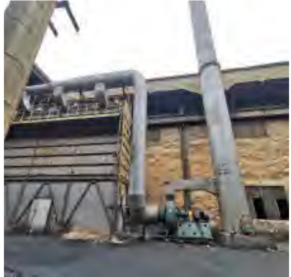
固溶酸洗 3#线布袋除尘器
