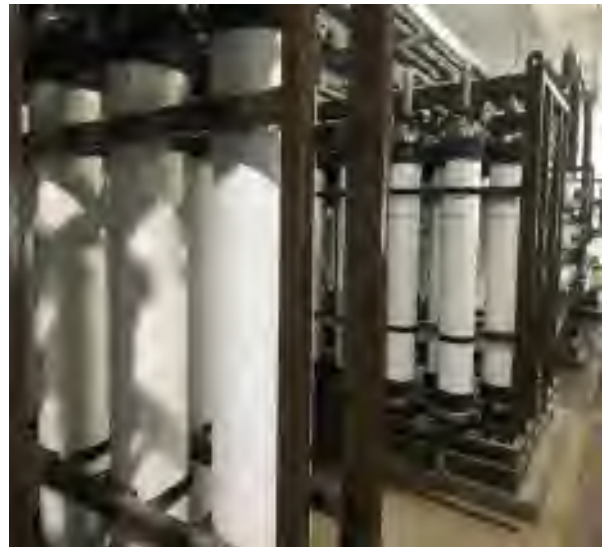
污水站反渗透设备
