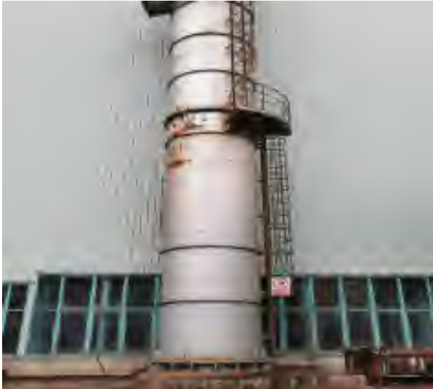
DRAP 退火炉废气处理系统
