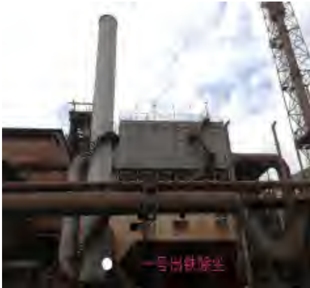
1#高炉出铁场废气除尘系统
