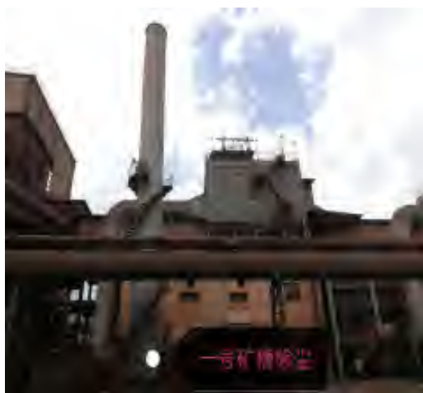
炼铁 1#矿槽除尘系统
