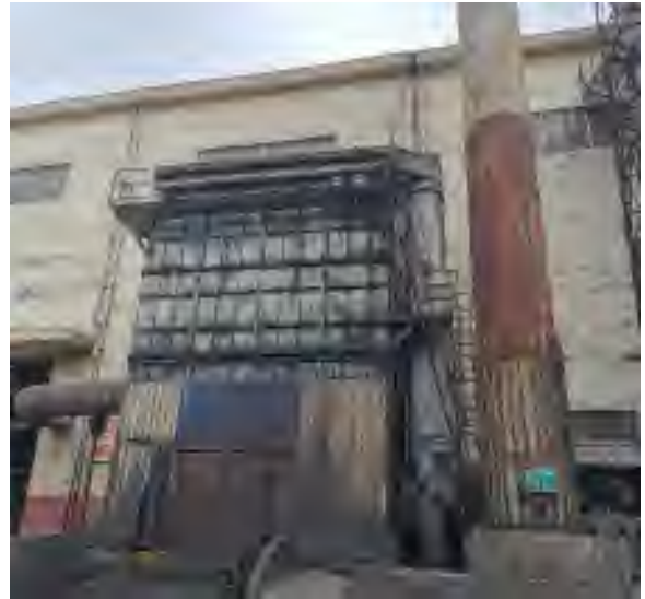
固溶酸洗 1#线布袋除尘器
