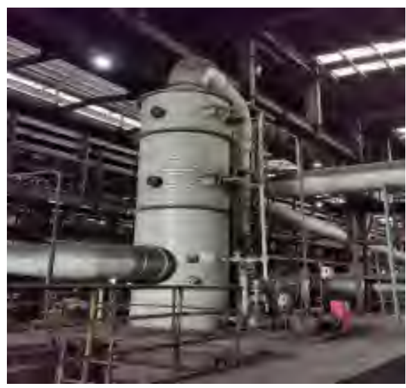
固溶酸洗 4#混酸洗涤塔
