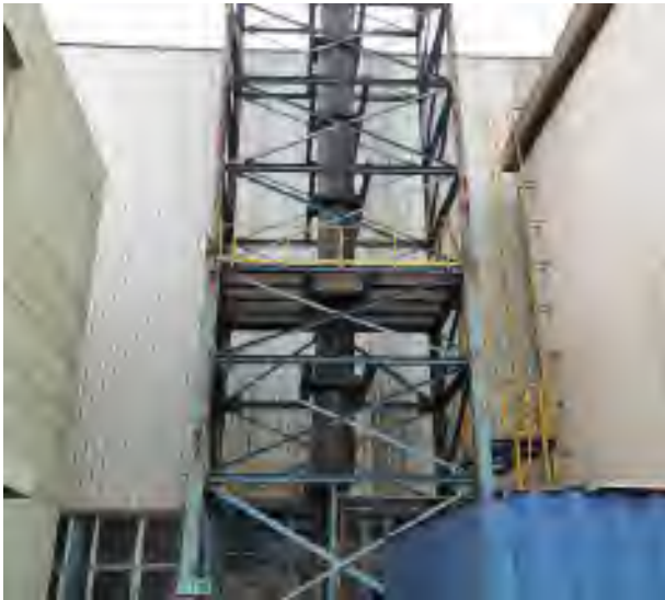
DRAP 电解酸洗废气处理系统排气筒
