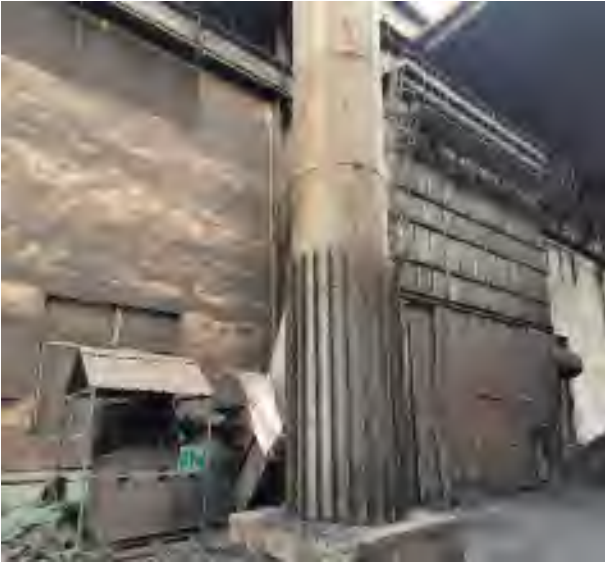
固溶酸洗 2#线布袋除尘器
