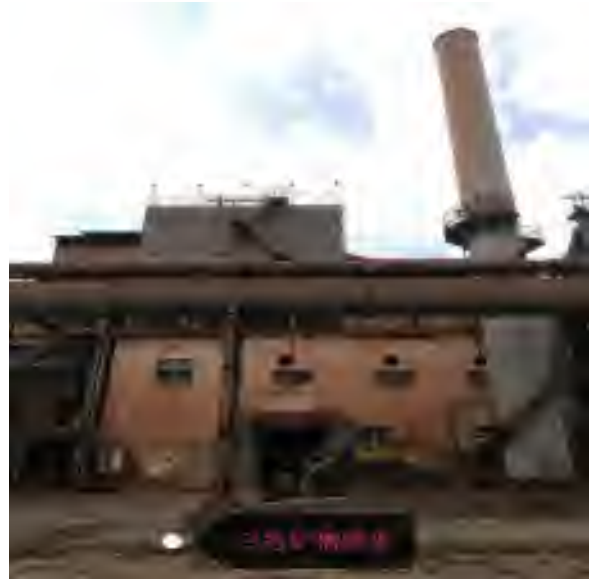
炼铁 3#矿槽除尘系统
