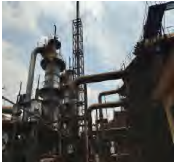
一次除尘 LT 干法除尘系统 (5#)
