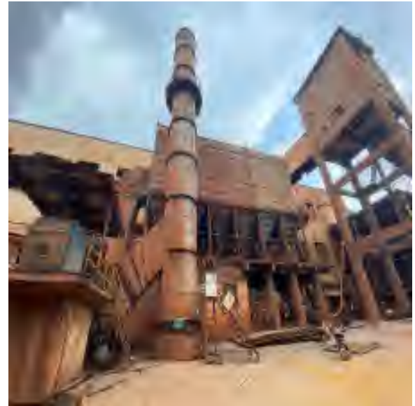
3#烧结配料室除尘系统
