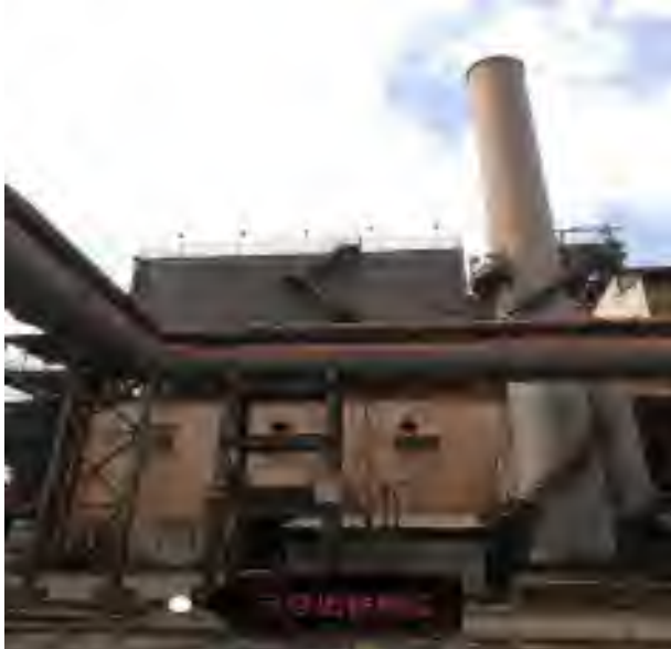
3#高炉出铁场废气除尘系统
