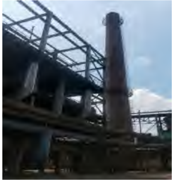
3#热风炉废气排放系统
