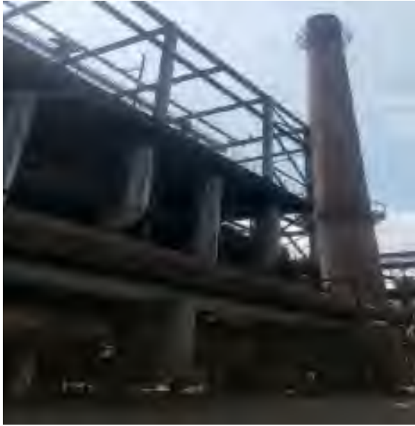
2#热风炉废气排放系统
