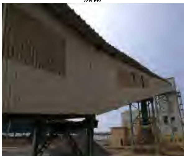
封闭式皮带及转运站
