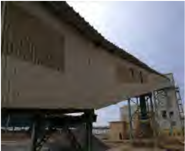
封闭式皮带及转运站
