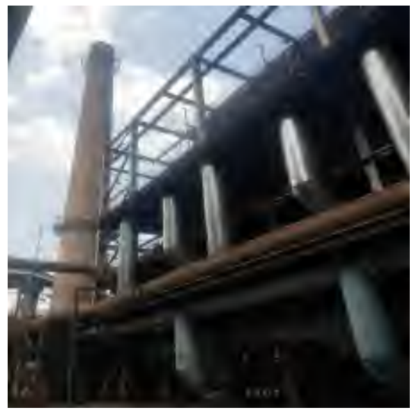
1#热风炉废气排放系统
