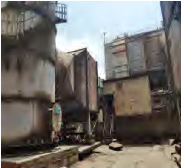
3 混铁炉与 LF 炉烟尘布袋除尘系统
