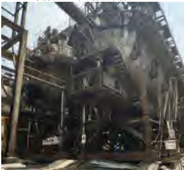
一次除尘 3#、4#静电除尘器
