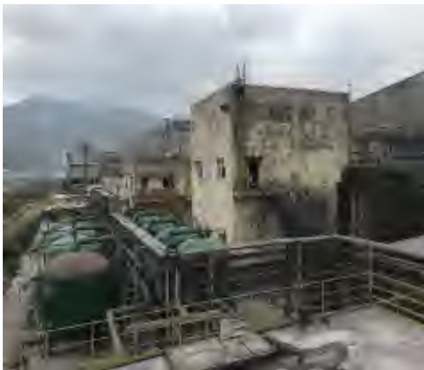
污水站超滤设备
