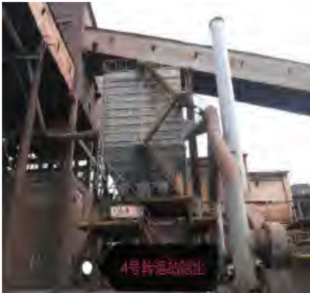
物料转运除尘系统
