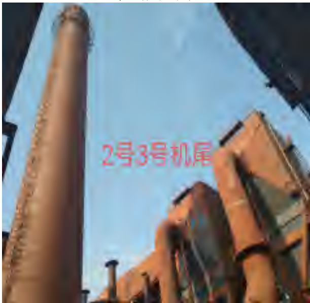
2#、3#烧结机机尾除尘系统
