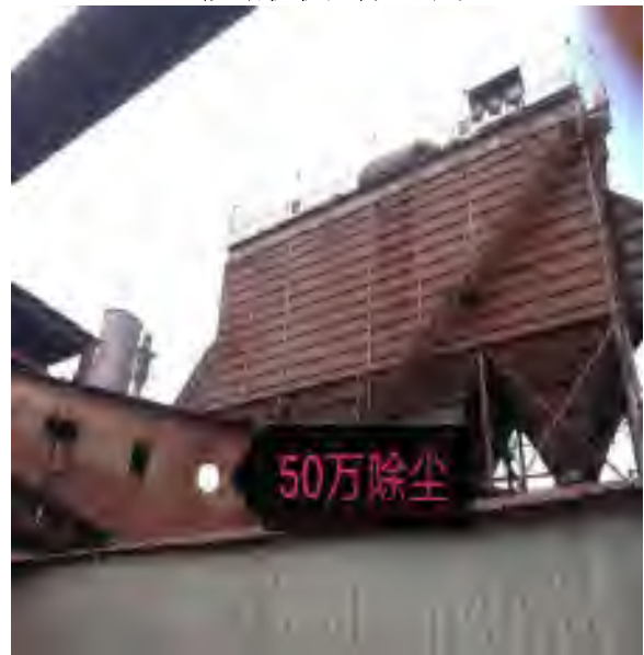
带冷机受料点、卸料点除尘系统
