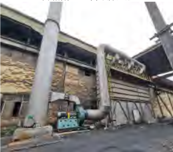
固溶酸洗 4#线布袋除尘器
