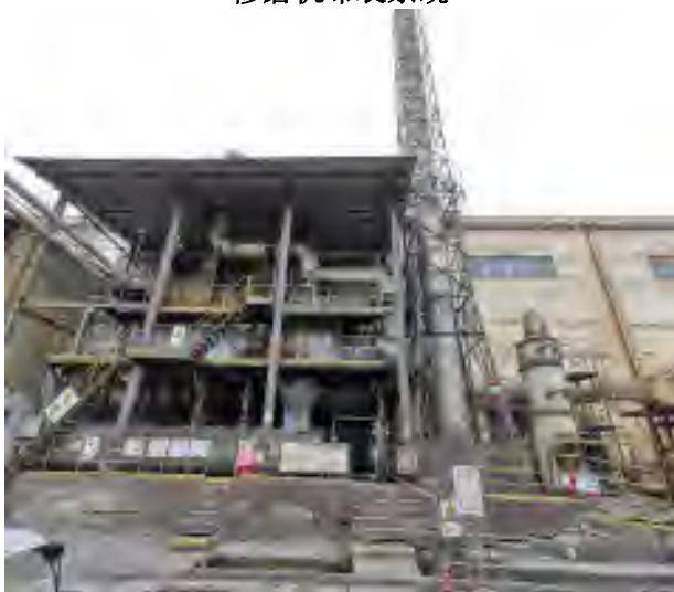
固溶酸洗 1#SCR 炉
