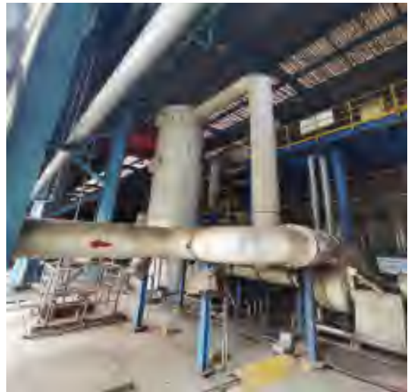
DRAP 脱硝废气处理系统
