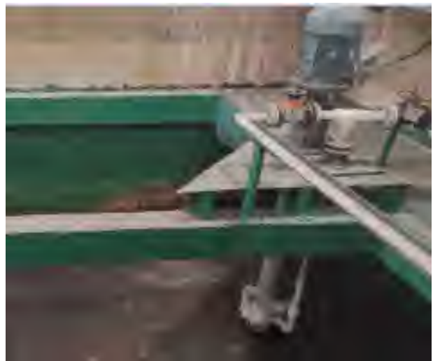
HRAPL 线事故池应急泵切换阀
