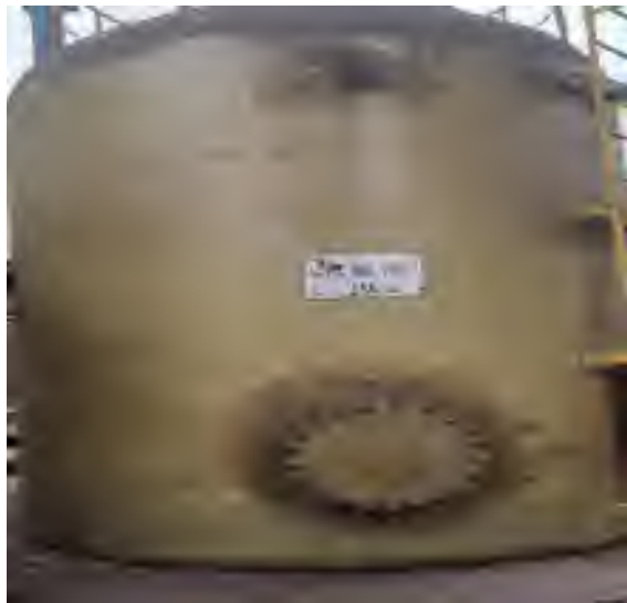
冷轧厂混酸事故收集罐
