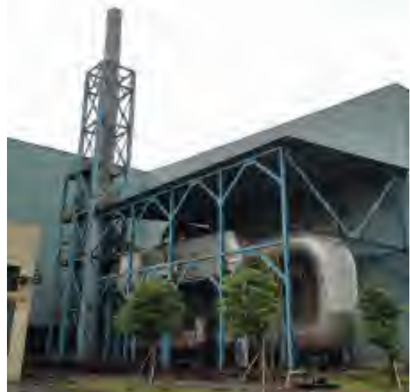
黑卷混酸酸雾处理系统排气筒
