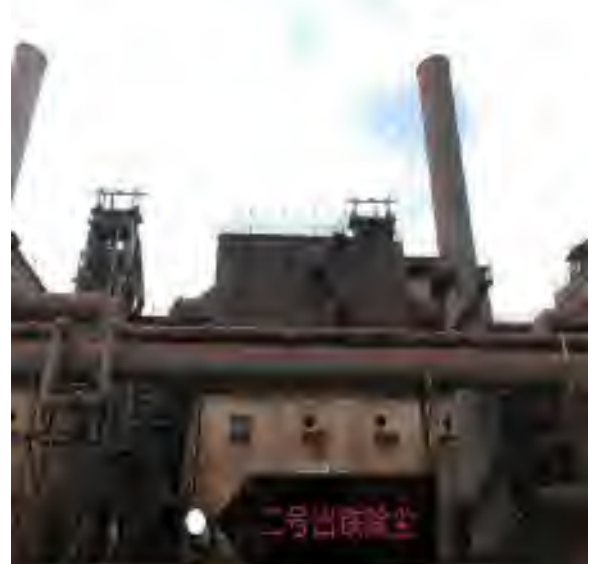
2#高炉出铁场废气除尘系统
