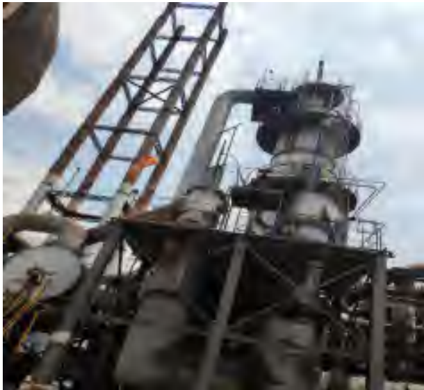
一次除尘 LT 干法除尘系统 (1-4#)
