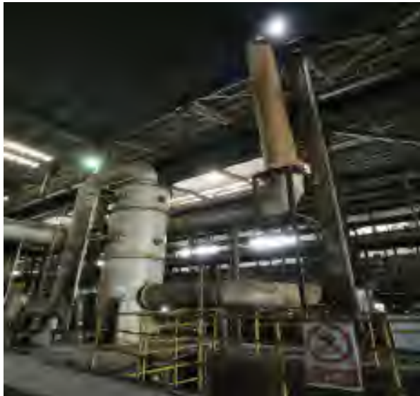
固溶酸洗 3#混酸洗涤塔
